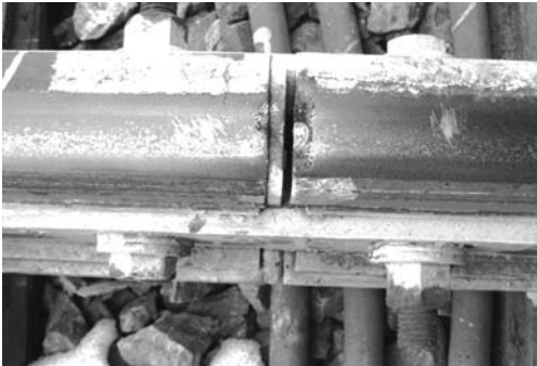
图 6 钢轨接缝处烧蚀
