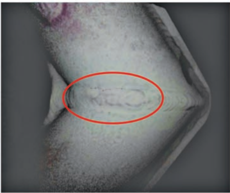
图 14 增加加强筋改进方案裂纹故障照片
