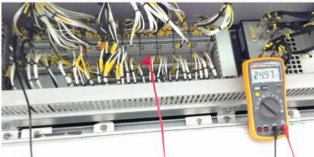
图 4 1 轴左侧撒砂控制电路电压测量
