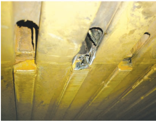
图 4 电机底部线圈烧损
