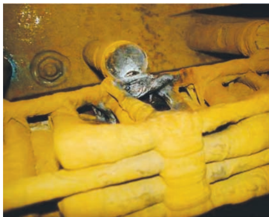
图 3 导线连杆与线圈连接处烧损
