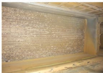
图 3 散热片外部被尘土覆盖
