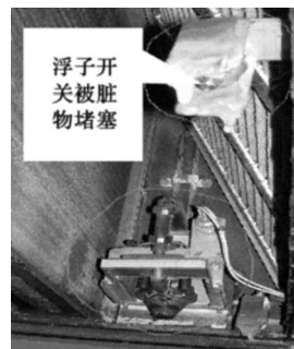
图 3 冷凝水排水不畅
