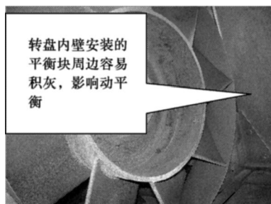
图4 冷凝风机扇叶转盘积灰
